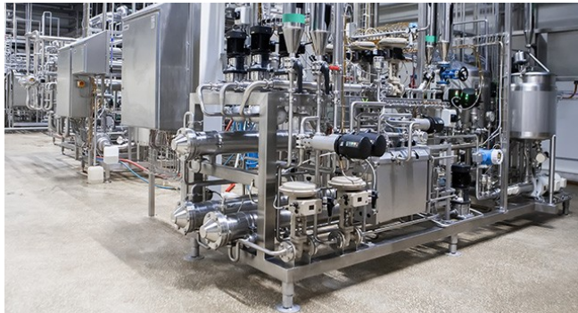
> Exemple de processus industriel de régulation de flux et pression Industrie cosmétique
